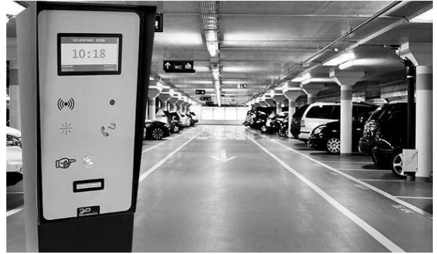
Figure 1 : système de contrôle d'accès
