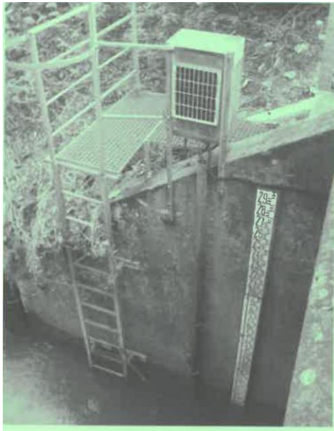
Fig. 2 : la station de collecte de Wirwignes
